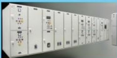
TỦ ĐIỆN TỔNG, TỦ ĐIỆN TẦNG
